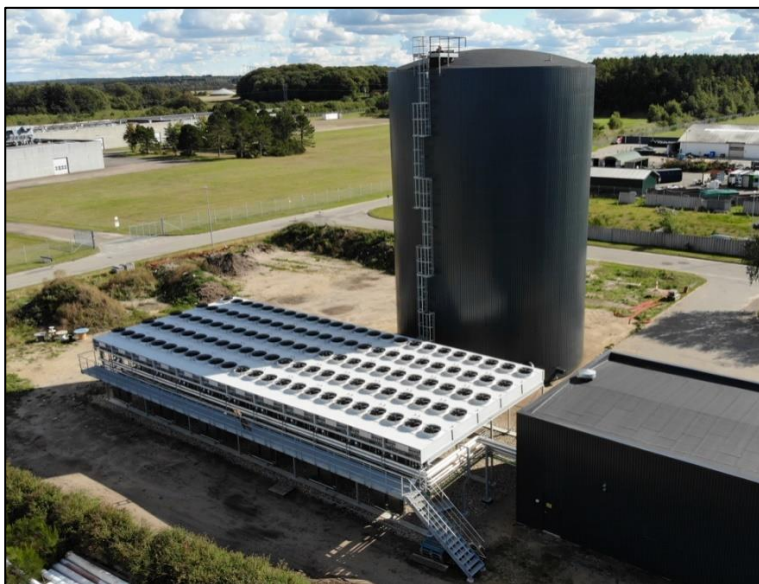
Figur 4: Et eksempel på et luft-til-vand varmepumpeanlæg på 3,5 MW fra Sdr. Felding Fjernvarme
